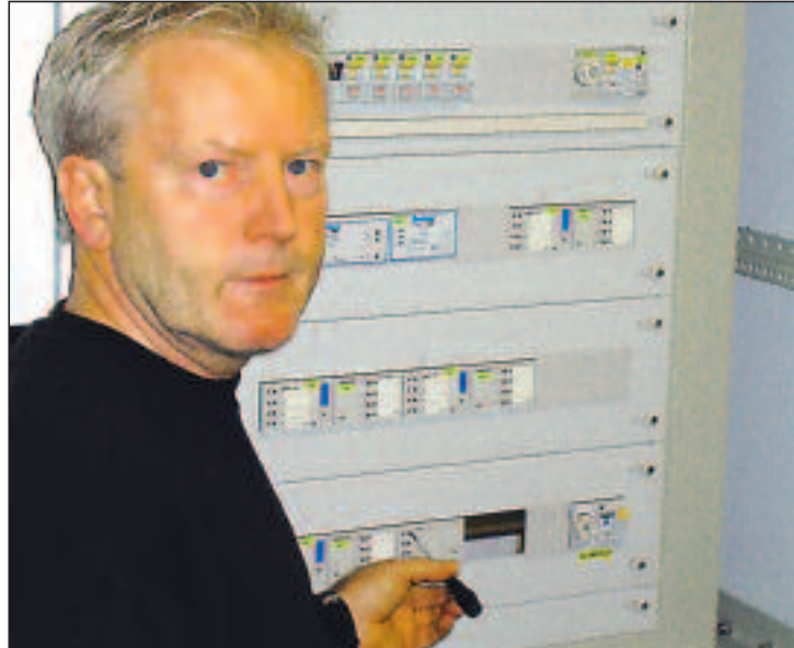
Ein EIB-Profi der Firma Kagerer bei der Inbetriebnahme einer Kundenanlage.
